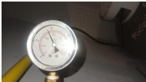
Figura 3 - (Foto do ensaio da rede de alimentação 32-2224
